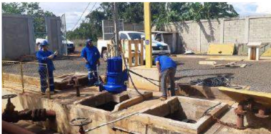
Fonte: PMSB (2020) –Poço de Sucção – EEE.
