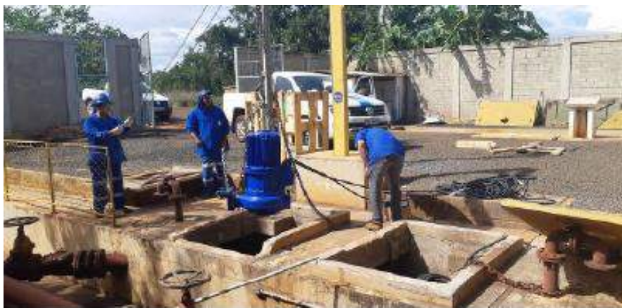
Fonte: PMSB (2020) –Poço de Sucção – EEE.
