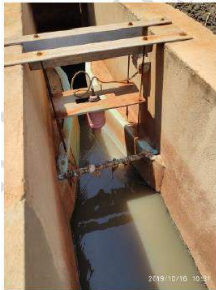
Fonte: PMSB (2020) – Calha Parshall.
