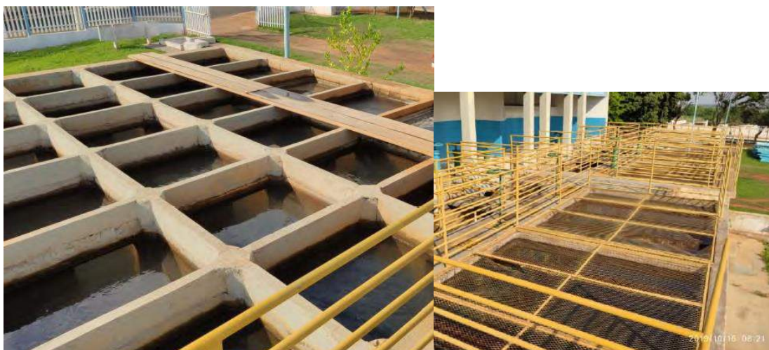
Fonte: PMSB (2020) – Flocculadores e Filtros.
