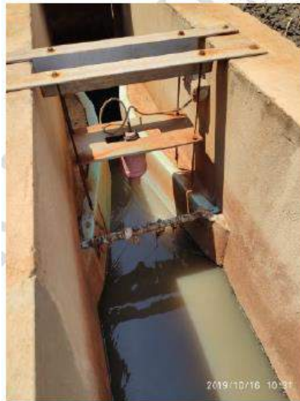
Fonte: PMSB (2020) – Calha Parshall.
